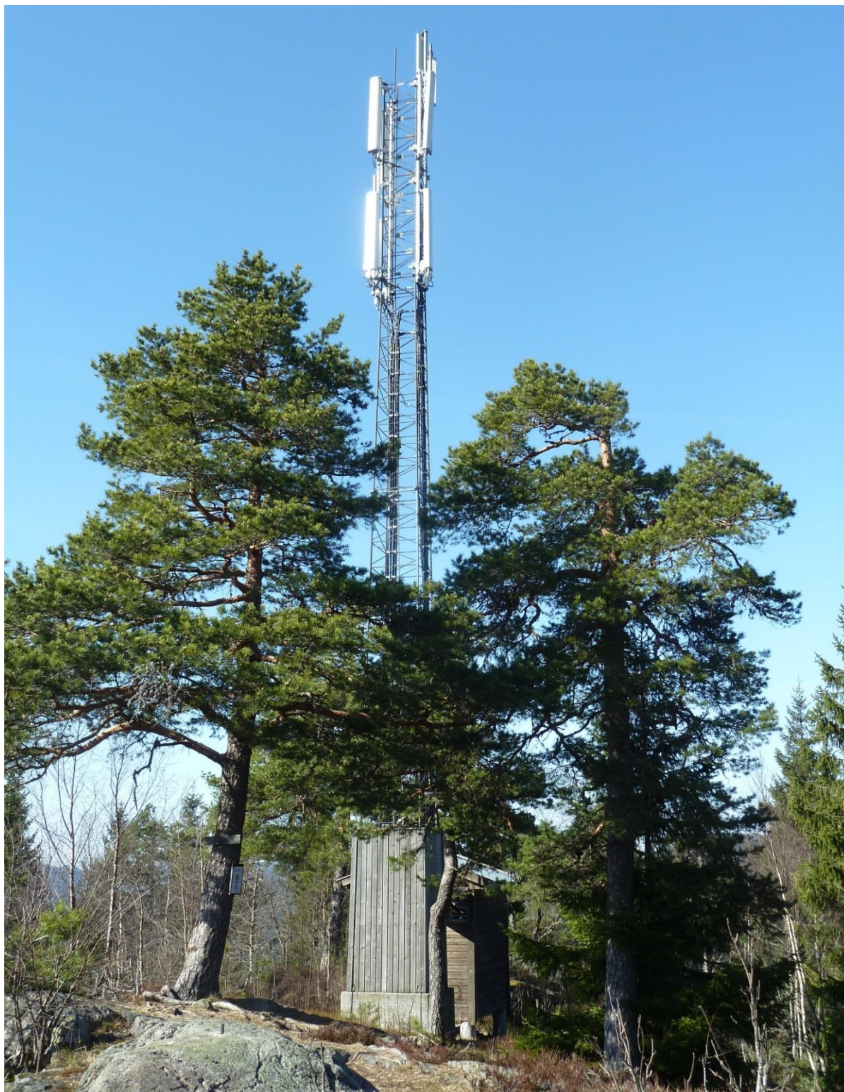
Basestasjon. Foto: Fylkesmannen i Telemark.
