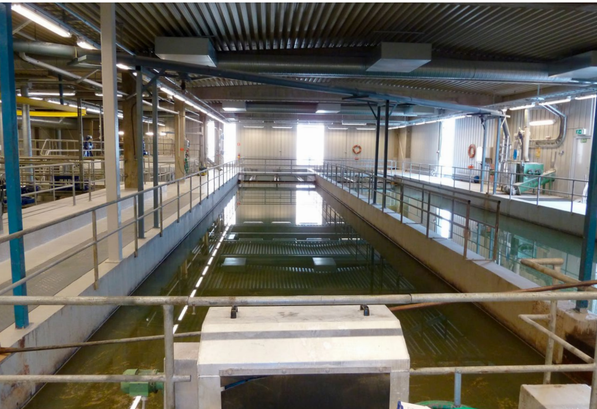
Sedimentanlegg ved Elstrøm renseanlegg i Skien. Foto: Fylkesmannen i Telemark
