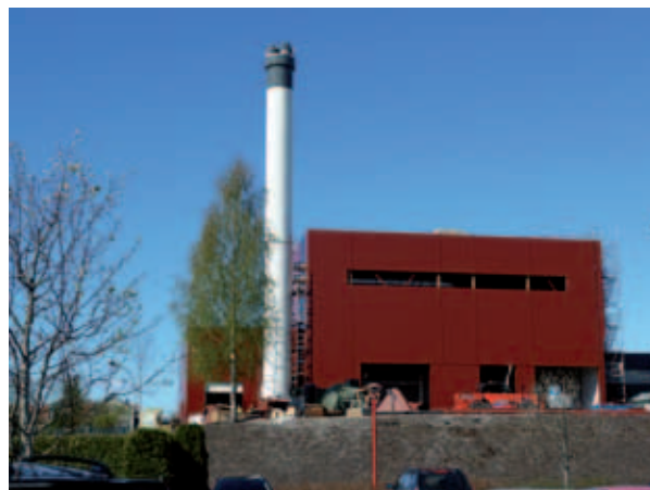
Fjernvarmesentralen i Skien.
