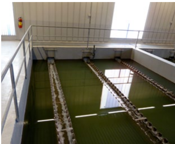
Foto: Fylkesmannen; Elstrøm renseanlegg, Skien
