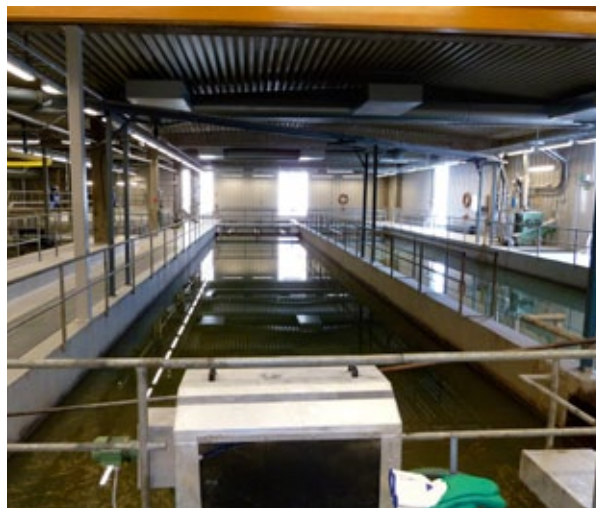
Foto: Fylkesmannen; Elstrøm renseanlegg, Skien
