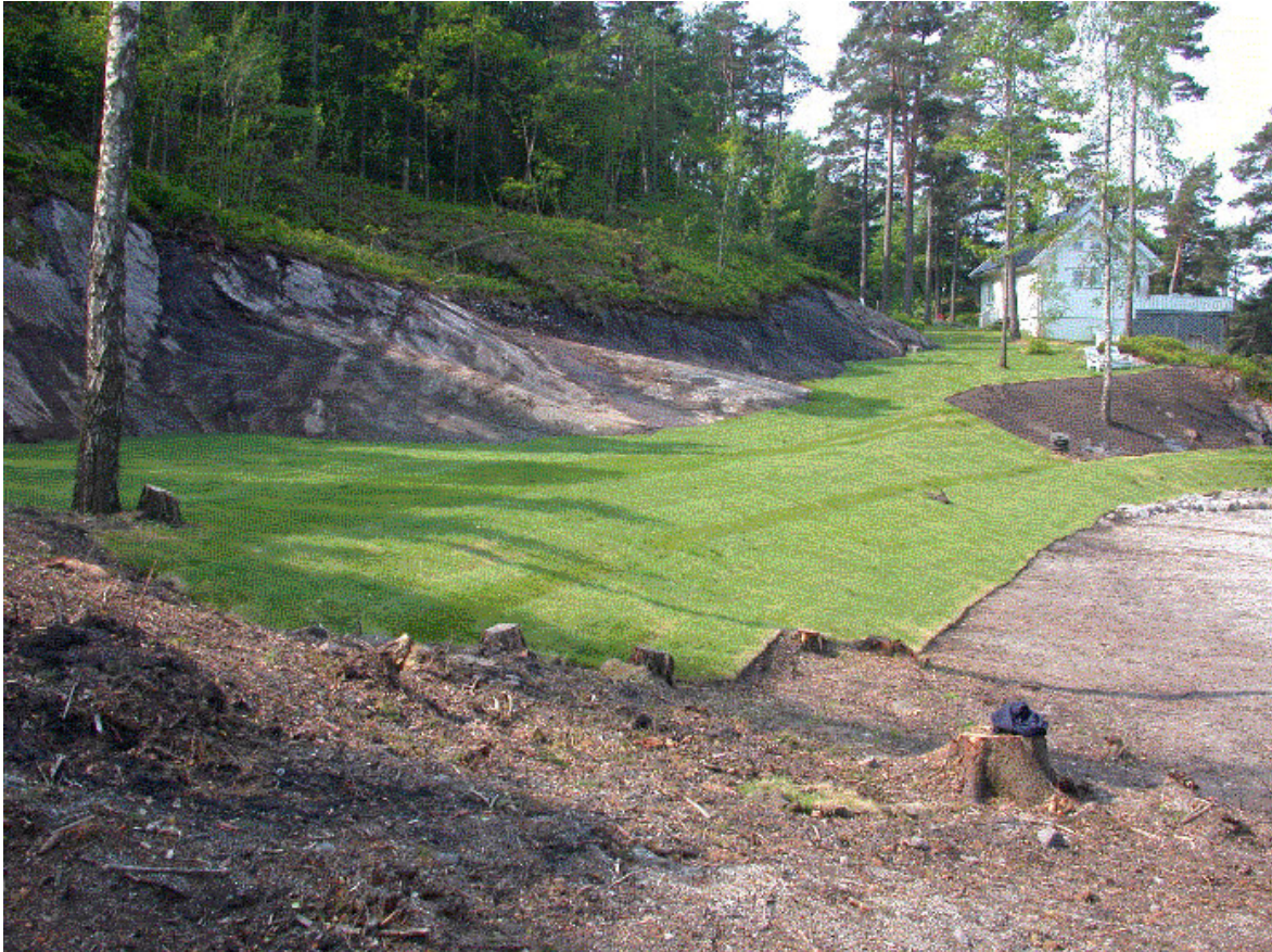
Ulovlig, privatiserende byggetiltak - badestrand Skåtøy, Kragerø 2005. Forelegg fra Økokrim: 200 000 kr. Foto: Fylkesmannen
