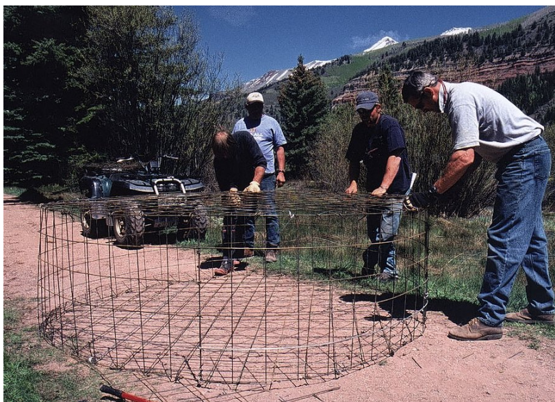
Figur 13.3. Filterbygging. Foto: S. Lisle
