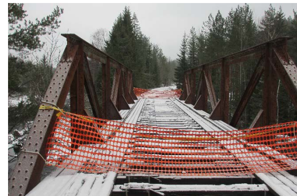
Figur 4-9 Heldøla bru over elva fra Neslandsvatn er avsperrert inntil det er gjennomført sikringstiltak
