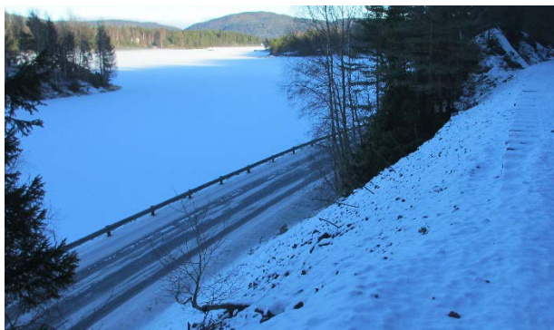
Figur 4-5 Skråning som må sikres. Den er bratt og høy med fylkesvegen i nedkant.
