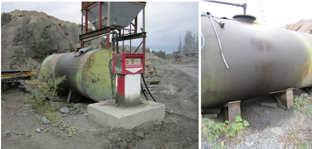
Dieseltank som også er omtalt i inspeksjonsrapportene fra 2011 og 2012. (Alle foto: Fylkesmannen i Oppland.)
