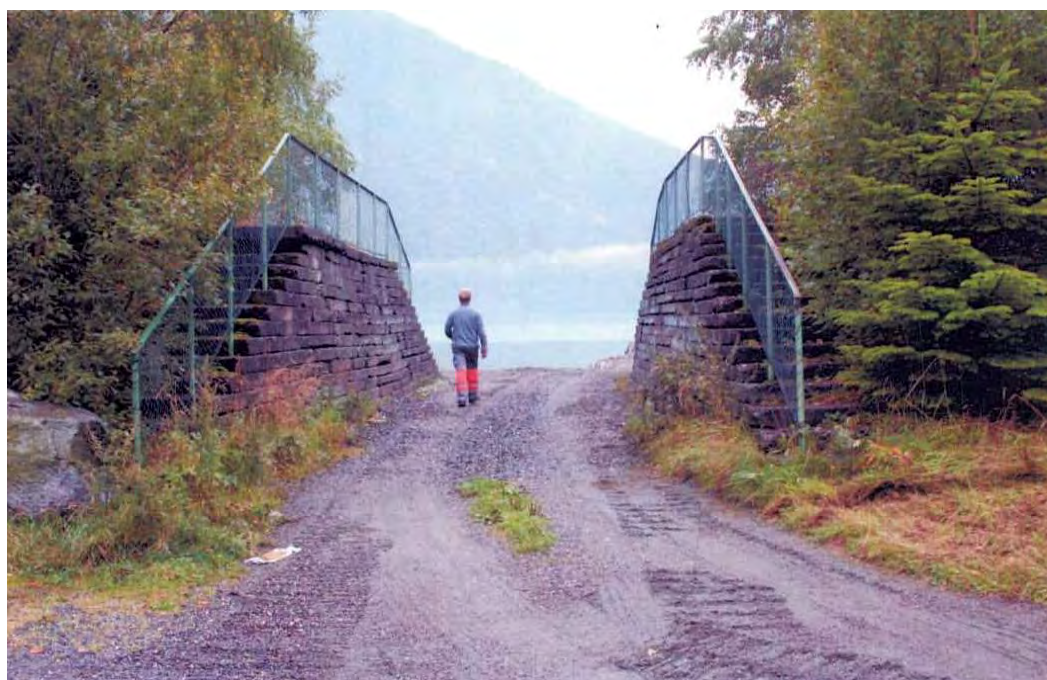
Figur 19: Sikringsvoll mot flodbølger i Årdalsvatn (øverst) med åpning for tilgang til vannet (Foto: Årdal kommune).
