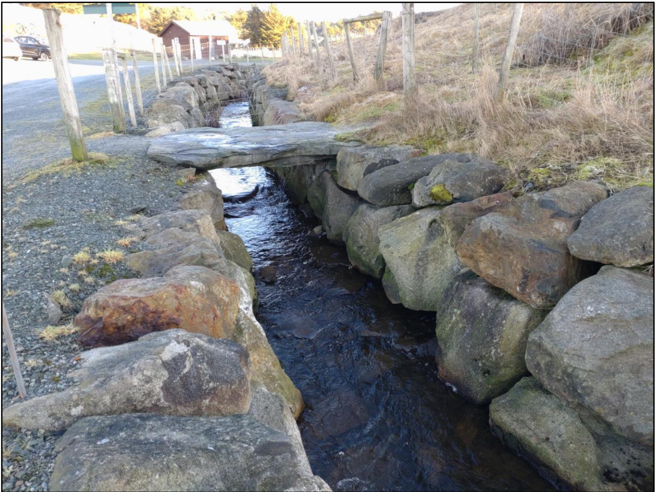
Figur 7. Etter oppgraderingen av det statlig sikra friluftsområdet ble bekken åpna. Bekken er sterkt forbygd i både sider og bunn. På lav vannføring forsvinner vannet ned mellom steinene, og er problematisk mht. fiskevandring og fiskeproduksjon (punkt nr. 5 i figur 2).
