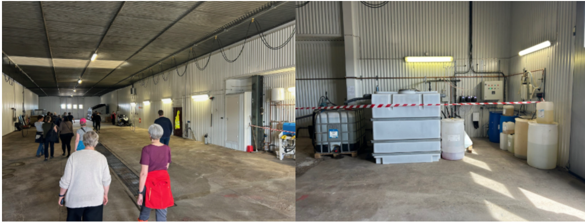
Storbilsvaskehall med vannslange i tak, sluk i gulv. Såper og desinfeksjonsmidler på bilde 2.
