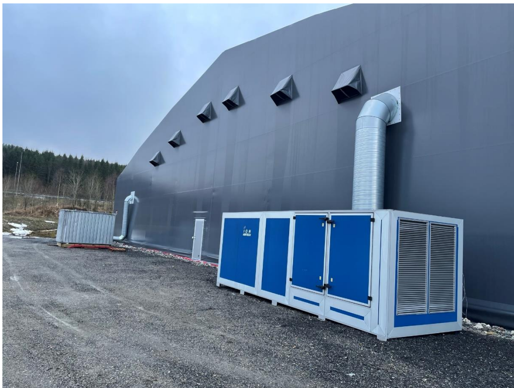
Figur 6: Baksiden av hallen som vender mot nordøst, hvor behandlet luft slippes ut. Anlegget som står lenger bak var ikke i bruk ennå på befaringstidspunkt, men er tilkoblet og planlagt tatt i bruk.
