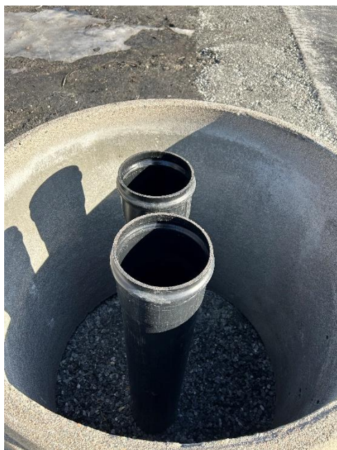
Figur 4: Opprinnelige prøvetakingsrør (som ikke er i bruk).
