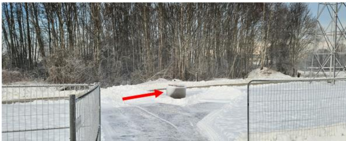
Figur 2: Prøvetakingsrør er plassert inne i betongkum markert med rød pil.
