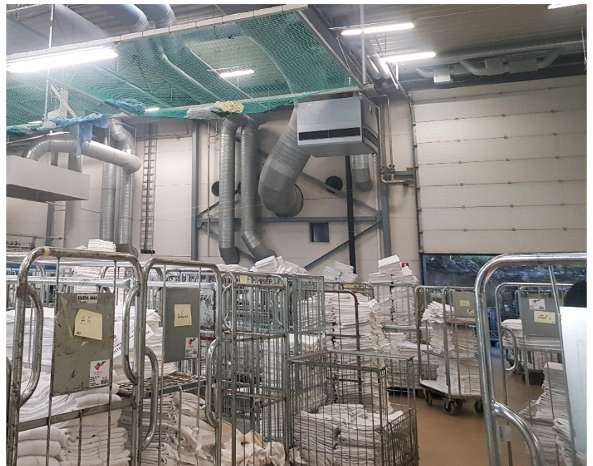
Figur 10. Romluftsprøve tatt innenfor porten. Åpen port også i bakkant av lokalet.
