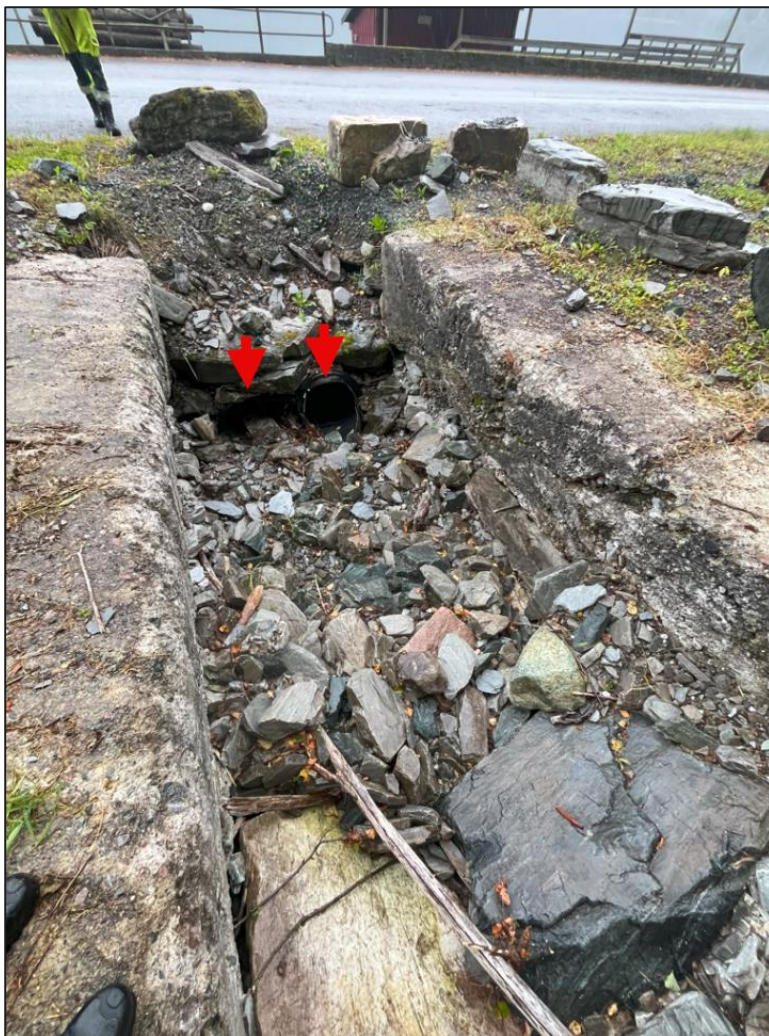
Figur 6. To rør med liten diameter (røde piler) under vegen og kulvert delvis fylt med stein.
