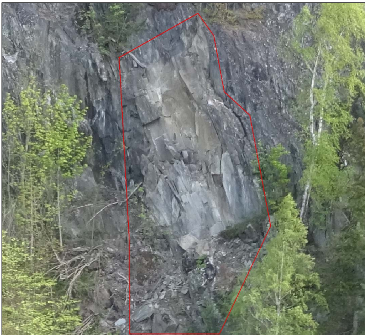
Foto 2. Løснеområdet for raset. Det må utføres en grundig rensk i området merket med rød strek. Rasbanen ned mot rasoverbygget må også renskes grundig.
