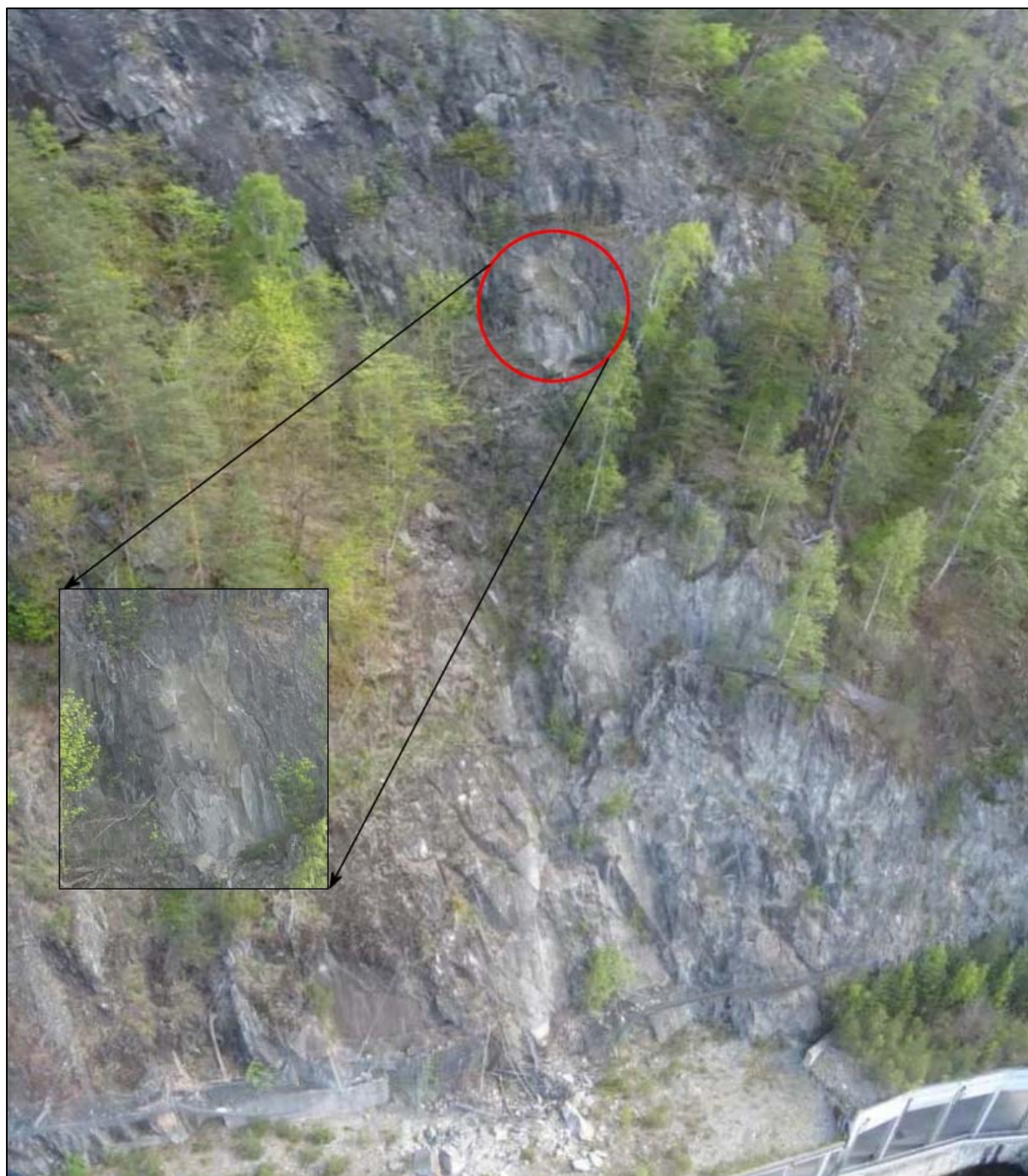
Foto 1. Løsneområdet for raset er indikert med rød sirkel. Lite foto er nærbilde av løsneområdet. Fanggjerdet er revnet av steinraset, og steinblokkene har lagt seg oppå rasoverbygget.
