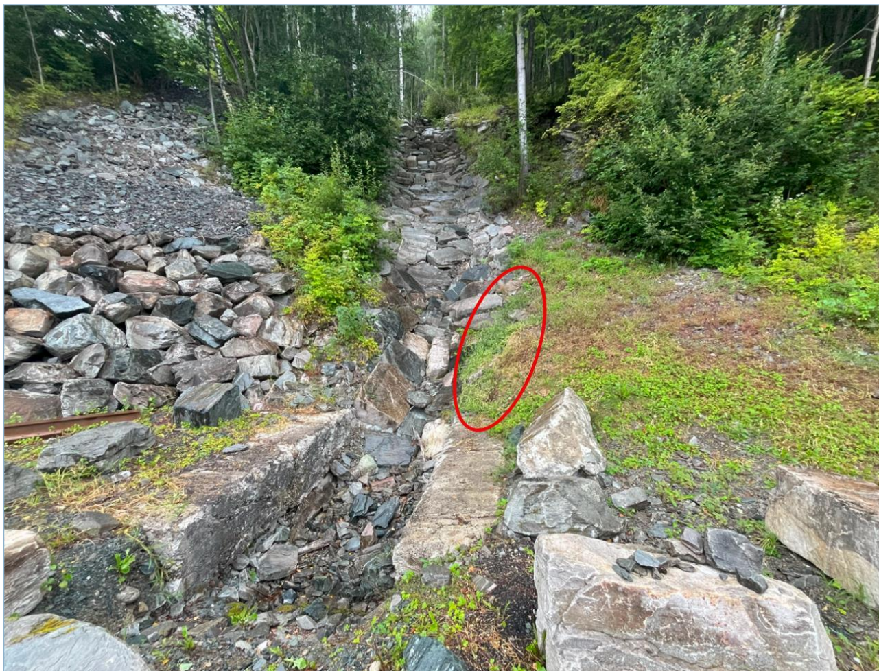
Figur 10. Det anbefales steinsetting i større bredde nedre del av bekkeløpet mot adkomstvegen.
