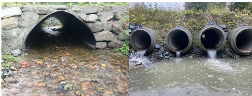
Figur 6. Bildet til venstre: Bruk av halvrør der naturlig elvebunn er bevart, som ivaretar naturlig fiskevandring. Bilde til høyre: Uheldig utformet kulvertrør under veg, som medfører forringelse for ovenforliggende vannforekomst, fordi det er skaper uheldig vandringshinder
