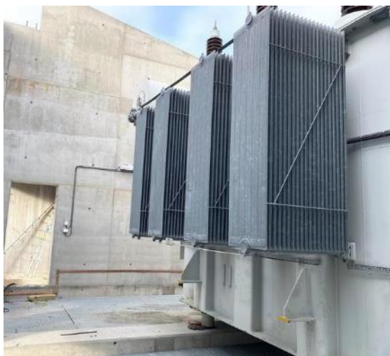
Figur 17: Tørdal stasjon er en moderne transformatorstasjon med tett betonggulv. Kilde: https://www.skageraknytt.no/2020/bygger-landets-forste-i-sitt-slag
