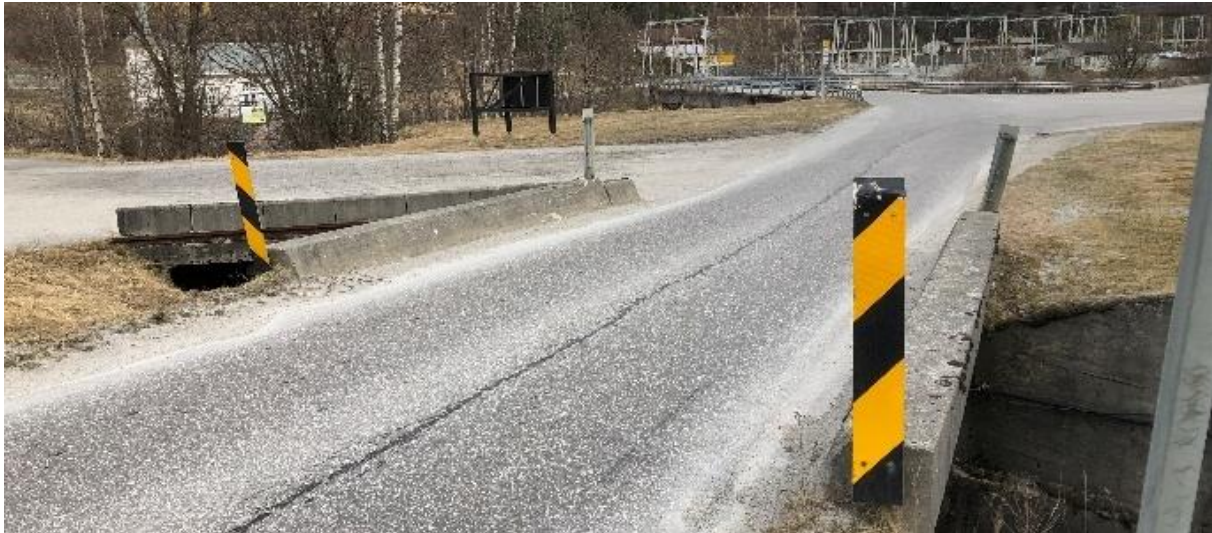
Figur 4-7 Problemområde 1. Brua over Grosetåe er smal og trafikkfarlig, spesielt på vinterstid.
