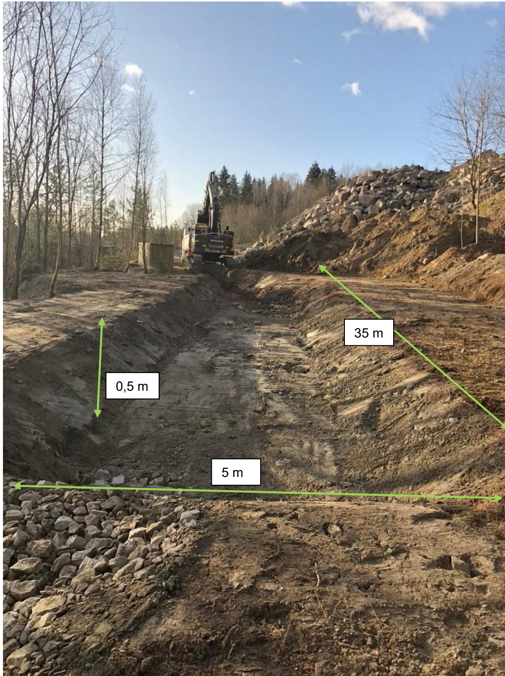
Figur 6: Bilde av sedimenteringsbasseng (tatt mot sør-vest) og tilhørende dimensjoner (LxBxH). Steinsatt overløp avbildet nede til venstre.
