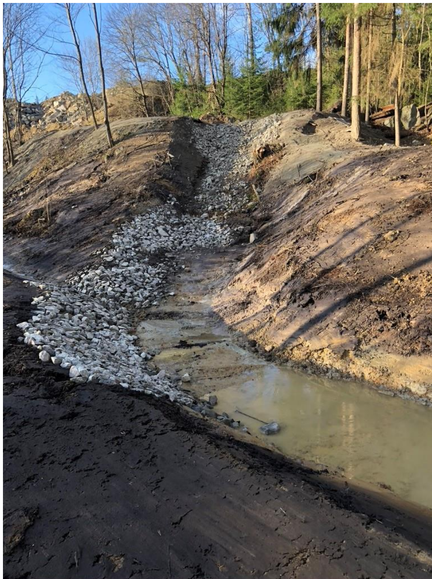
Figur 7: Steinsatt overløp fra sedimenteringsbasseng. Silt-/leirholdige løsmasser i bunnen danner et tett sjikt i løsmassene hvor overvannet hindres fra å infiltrere og/eller grunnvannet strømmer ut i dagen.
