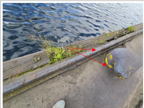
Bilde 19: Maling på metallkonstruksjoner langs kaikanten.
