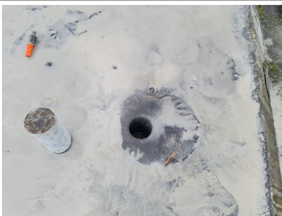
Bilde 8: Prøvetatt betong fra prøvepunkt BORR 04-01.
