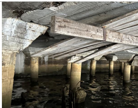
Bilde 15: Prøvetatte betongpilar (runde pilaler vist i bildet) undersiden kaidekktet.
