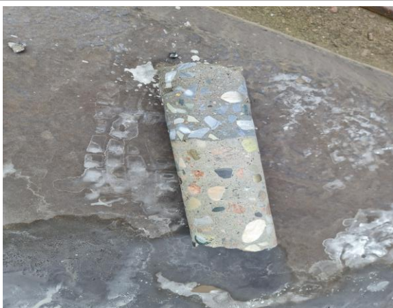
Bilde 10: Bilde som viser betongprofilen i kaia, toppdekket (mørkere lag) og nedre lag av lysere betong.
