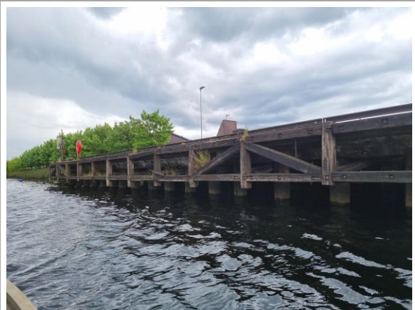
Bilde 20: Konstruksjoner i kreosot impregneret trevirke rundt og under kaidekket.
