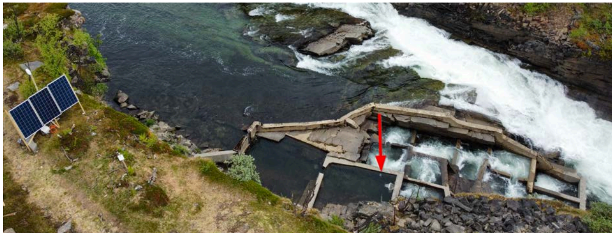
Figur 2: Oversikt over installasjonen. Solcelleanlegg med styringsskap og 4G mast kan sees til venstre i bildet. Kamera er indikert med en rød pil i fisketrappen.
