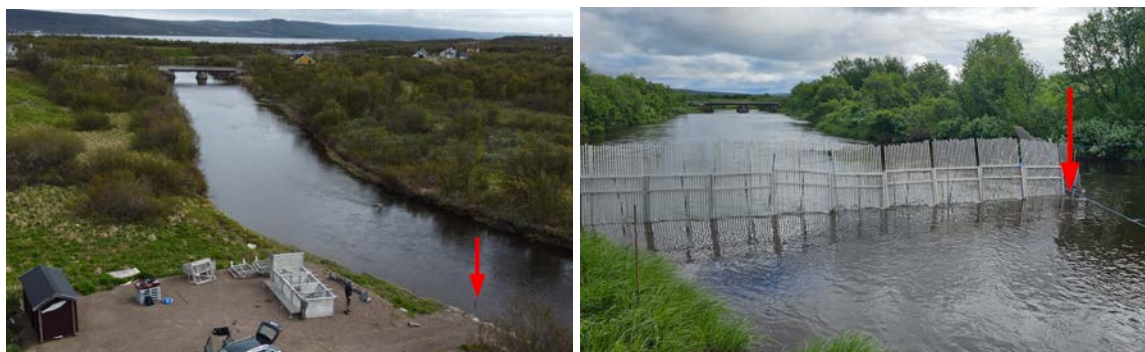
Figur 2 venstre: Oversikt over installasjonen. Styringsskap var montert på bua til venstre i bildet. Kamera er indikert med en rød pil i elven 12 juni. Høyre: Lokal kontakt hadde mulighet til å enkelt flytte systemet når gjerdet var installert, og flyttet til denne posisjon 29 juni.
