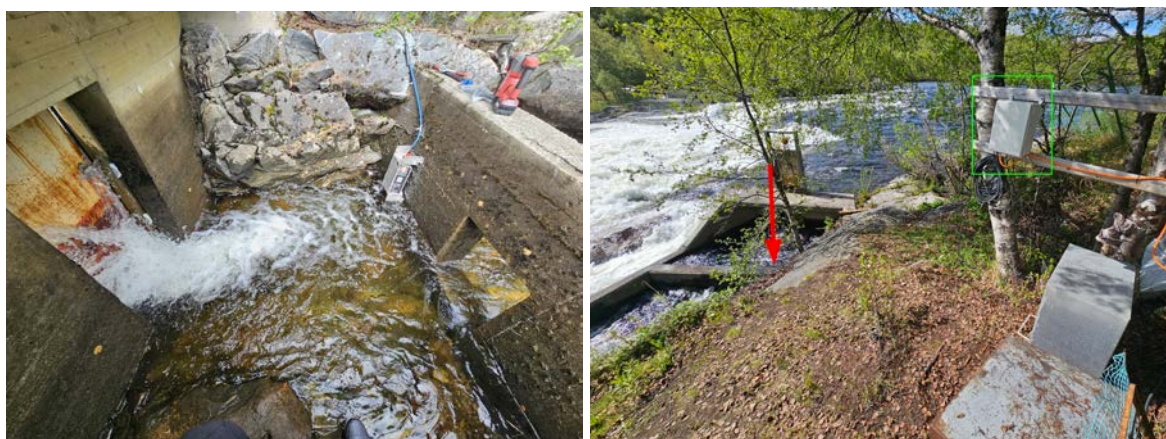
Figur 2 venstre: Oversikt over installasjonen i laksetrappen. Høyre: Kameraplassering med rød pil, styringsskap markert med grønn ramme.
