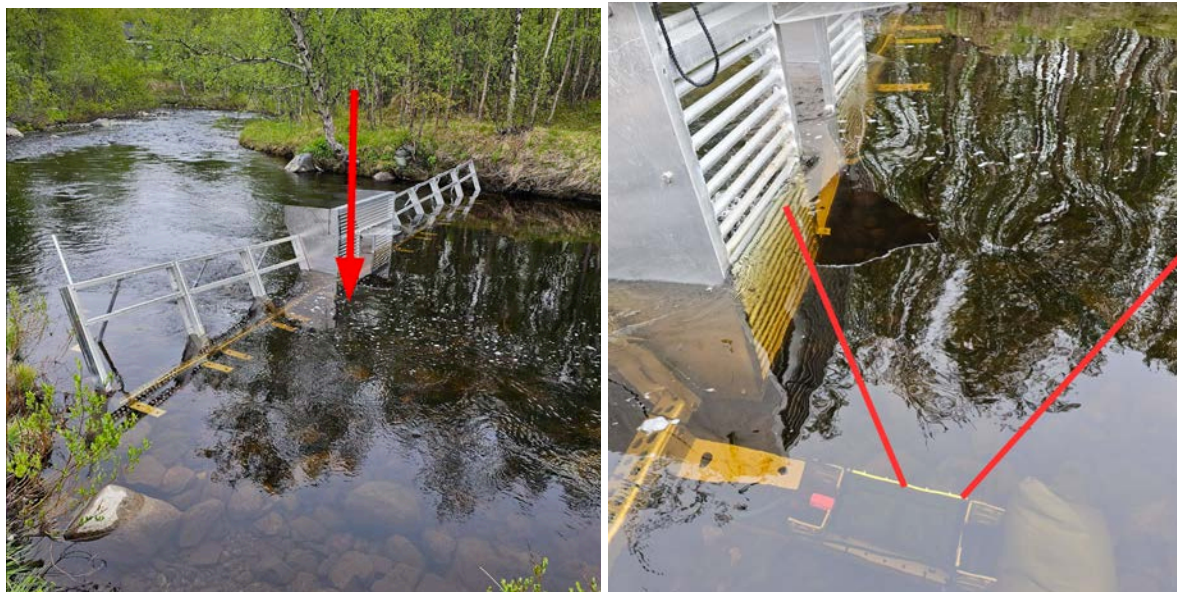
Figur 2 venstre: Oversikt over installasjonen. Styringsskap var montert på bua til venstre i bildet. Kamera er indikert med en rød pil i elven 12 juni. Høyre: Lokal kontakt hadde mulighet til å enkelt flytte systemet når gjerdet var installert, og flyttet til denne posisjon 29 juni.
