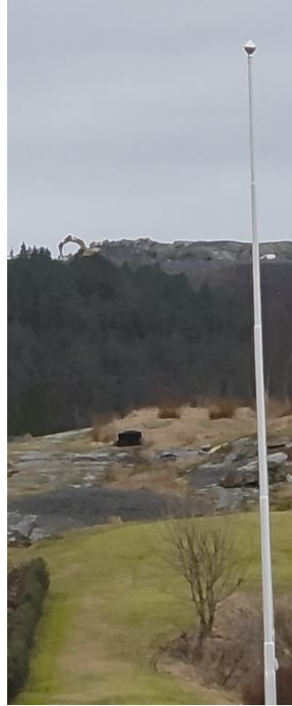
Figur 2: Gravemaskin synlig på toppen av bruddet samtidig med pigge-lyd dokumentert på film. Skjerm bilde tatt av filmopptak innsendt ifm. støyklage datert 18.03.2026 (Ref. sak 2017/9400-381).
