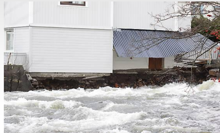
Skade etter flommen
