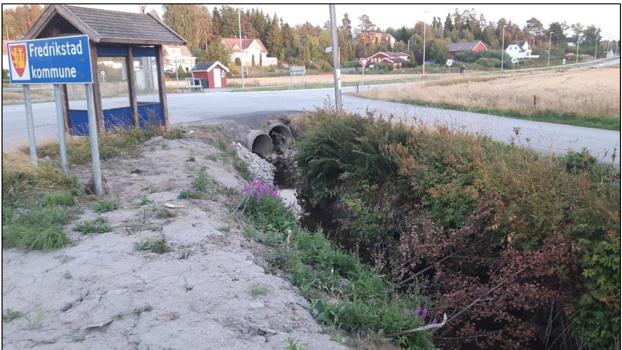
Bilde 6. Saltnesbekken rett nedenfor Fv. 116. Her ble det rensket og steinsatt sommeren 2018. Det er midlertidig lagt noen greiner over bekken for å skjerme mot sola. Her bør det beplantes med svartor på venstre bekkekant..
