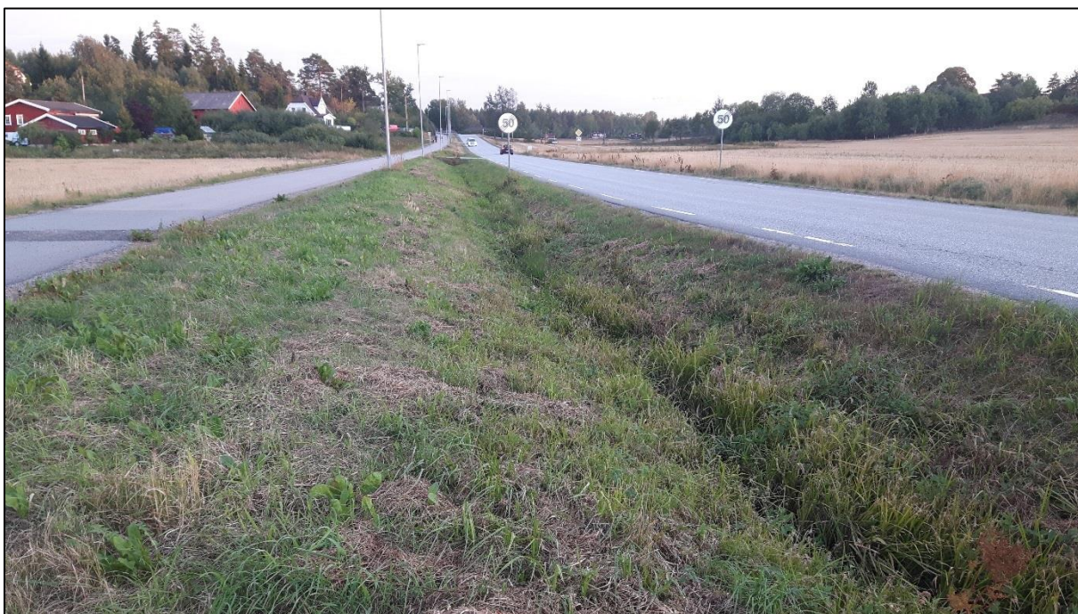
Bilde 8. Saltnesbekken langs Fv. 116 i Fredrikstad kommune. Strekningen ble ryddet av medlemmer i Onsøy JFF og Råde JFF i august 2018, etter at kantslått hadde fylt mye av bekken med gress. Hele denne bekkestrekningen bør renskes og tilføres stein.
