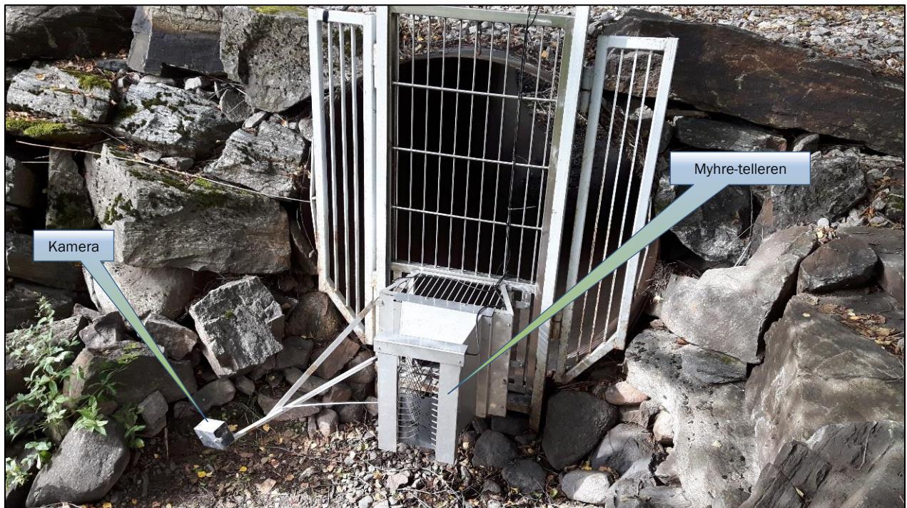
Fig. 6. Myhre telleren m/kamera, montert på grind ved rør/kulvert under veg øverst i sideløpet. Vannføringen var på dette tidspunkt (17.10.2013) kun 3,17 m 3 /sek., og det var ikke vann i sideløpet.
