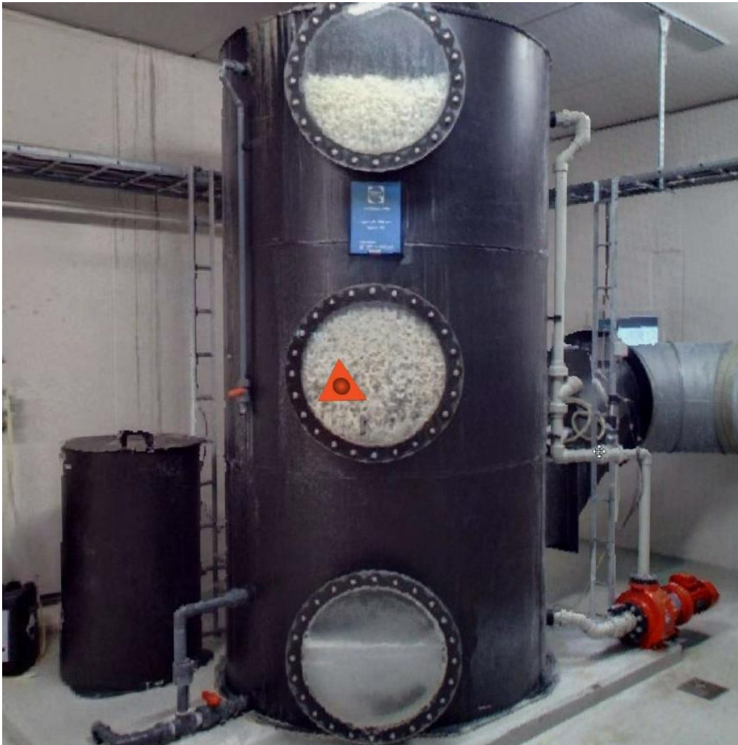
Figur 9. Luktreduksjonsanlegg for urent avtrekk.
