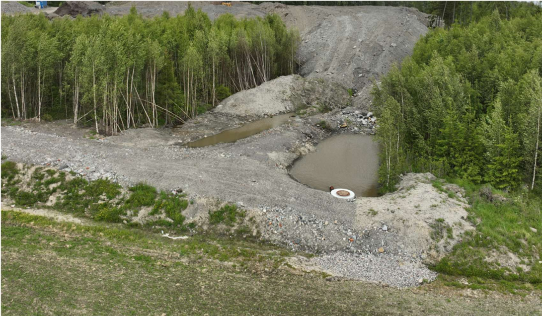
Figur 10 Dronefot, sedimentasjonsbasseng og kum i sør. Videreføres til drensledning under jordet mot sør
