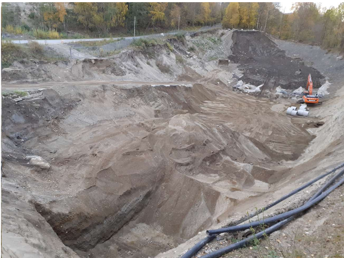
Figur 4. Foto av Egge Massedeponi, 18.10.2023, sett fra sør-østre hjørne. I nordre del (bortre del i foto) sees etablering av bunnsikring.
