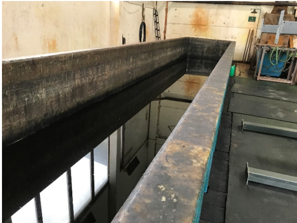
Bilde 2 , syrebadet hos Galvano Industri AS må tømmes og fornyes med jevne mellomrom
