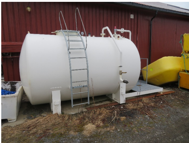
Bilde 3. Dieseltank uten risikovurdering.
