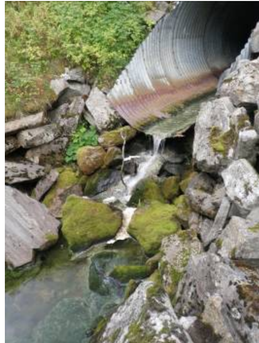
Neppelbergelva. Vannføringen vist i kulvert gjennom veien
