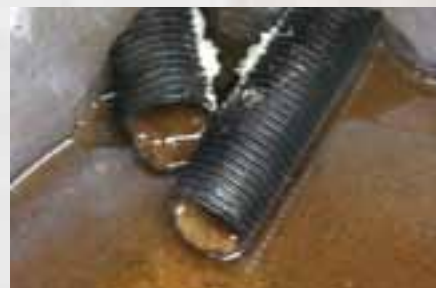
Grøftekum på areal med rustutfelling. Fleire sidegrøfter har innlaup her, og vidare transport i hovudgrøft. Tilgang til grøftespyling. Foto: Lars Sørdal
