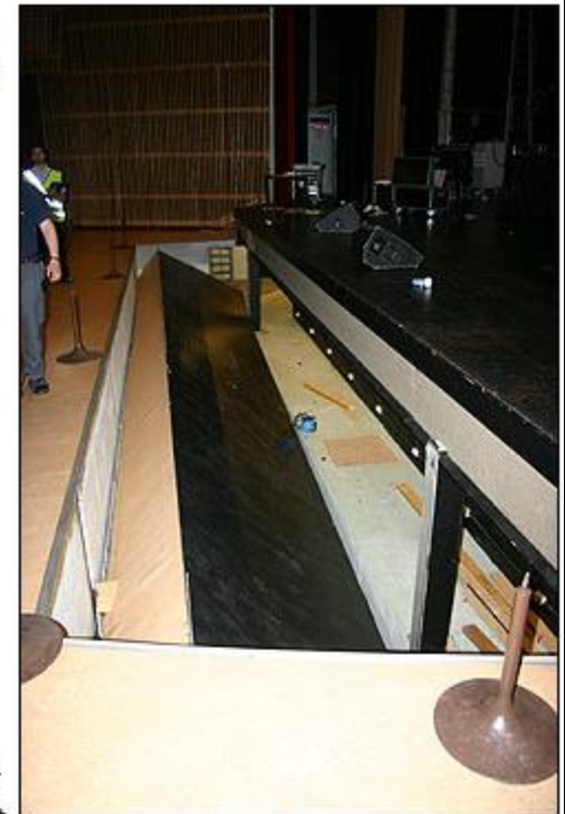
SCENEN KOLLAPSET: En mengde elever falt ned i to meter dype orkestergraven da gulvet kollapset under Spetakkel-konserten. Foto: Roy Sunde
