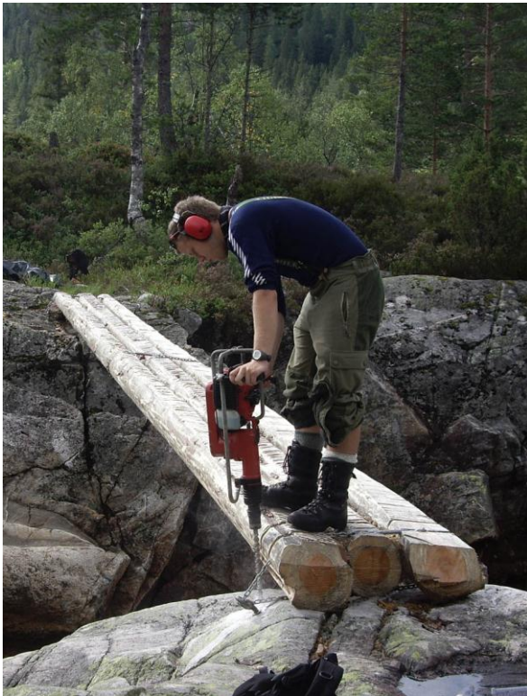
Figur 10: SNO i arbeid med å lage ny bru (nr. 1) over eit sidelaup av elva. Foto: Peter Hermansen.
