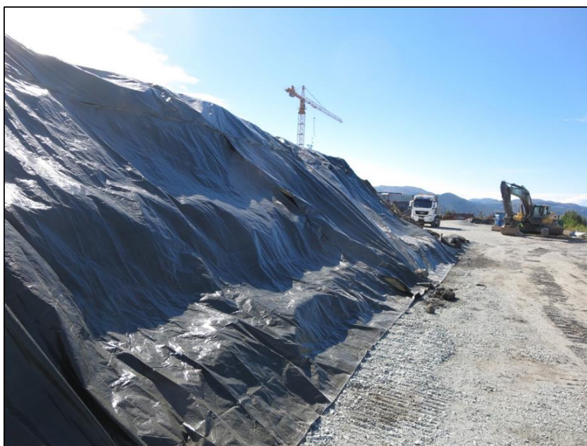
Figur 10. Eksempel på tildekking av masser i mellomlager og tilført subus-lag på adkomstvei.
