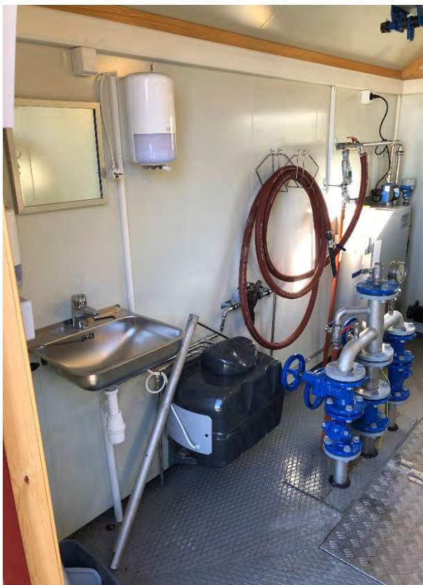
Figur 9 – Eksempel fra arbeidsforhold i en ny pumpestasjon
