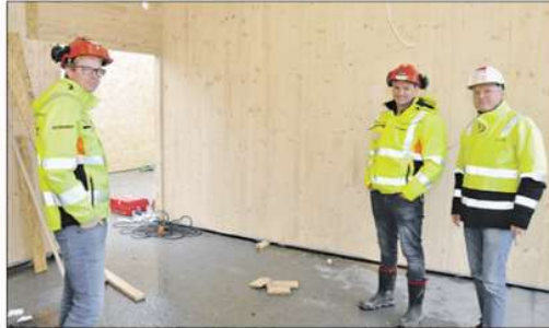
Bruken av massivtre er typisk for prosjektet på Biri omsorgssenter. Arbeidsløser Lars Erik Kristiansen og prosjektleder Ole Jørgen Levy hos Betonmast er i rute konstaterer Kai Struksnæs fra Sweco Norge som er byggherreombud/byggeleder for Gjøvik kommune.
