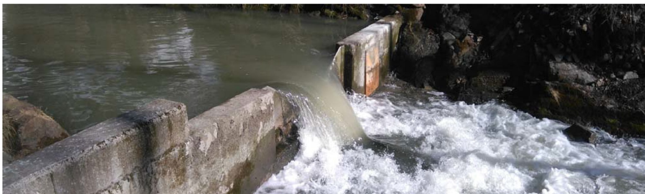
Figur 5. Støpt V-overløp som danner vandringshinder i den nedre delen av Nadderudbekken (Foto. Roger Roseth).
