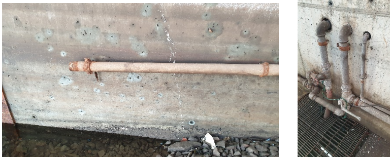
Figur 2. Ett av rørene koblet til pumpesumpen leder til direkte utslipp nederst i slippen, utenom rensenanlegget (foto: Statsforvalteren i Nordland).
