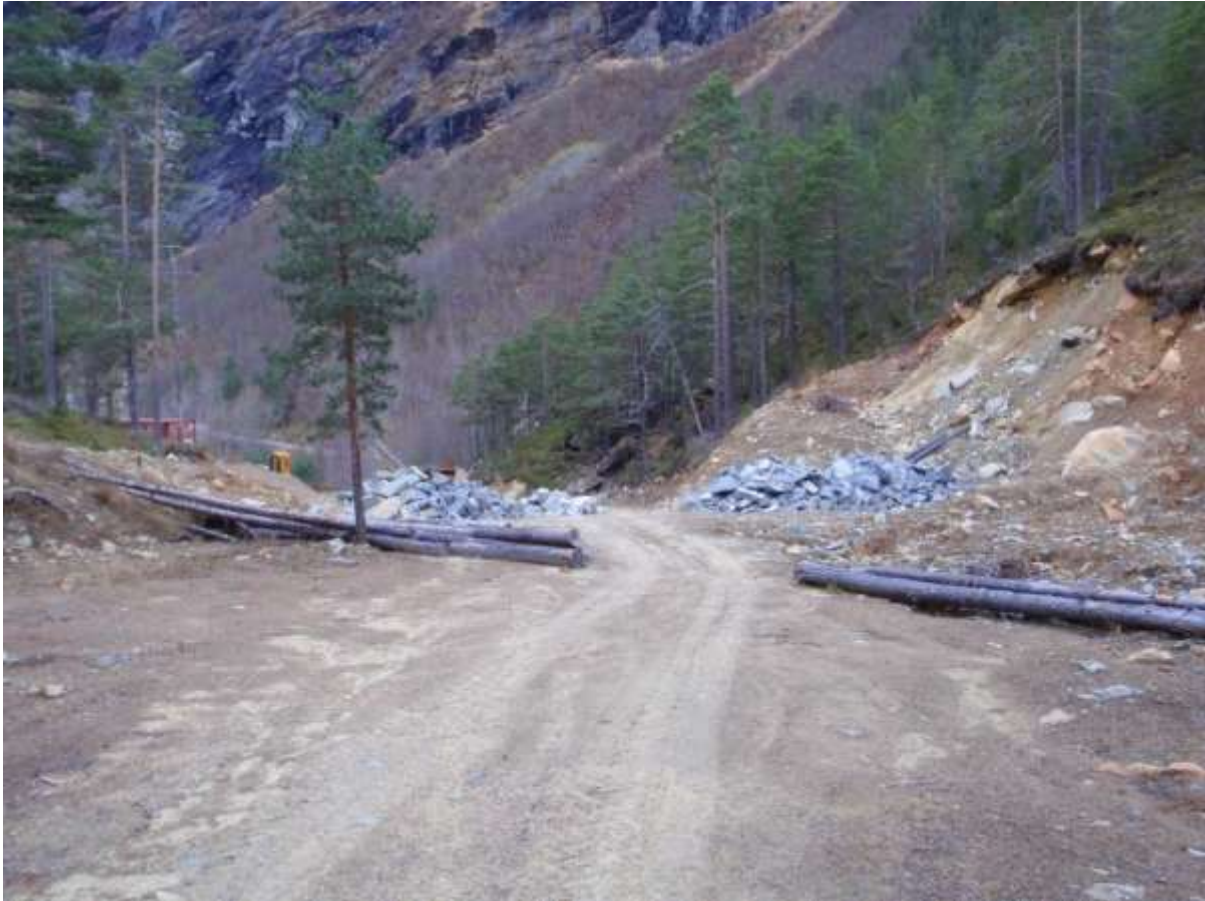
Figur 23. Masseuttak og gruvedrift er sammen med fortsatt skogsdrift – og dermed ytterligere fragmentering av et allerede lite areal – blant de viktigste truslene mot den særnorske naturtypen olivinskog. Her nederst fra øvre del av Onilsafeltet i MR Norddal, november 2008. Det er nylig kommet fram ønske om å gjenoppta uttaket av masser her, som aldri kom skikkelig i gang. Foto: Dag Holtan ©.
