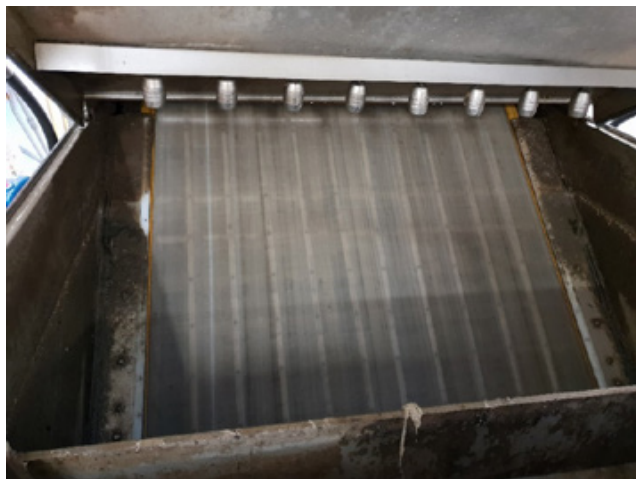
Bilde 8: Asfaltstøv som tetter silduk på Kvalvikodden RA, Bodø.
