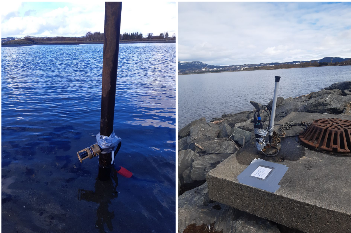
Bilde 4. Livestasjon (tv) montert på påle i tidevannspåvirket område ved Hellstranda. Livestasjonen overfører i sanntid registreringer fra merket fisk via kabel til mottaker koblet til lokalt LoRaWAN nettverk på land (th). Livestasjonen registrerer kun fisk når stasjonen er dekket av vann. Foto: Jan Grimsrud Davidsen
