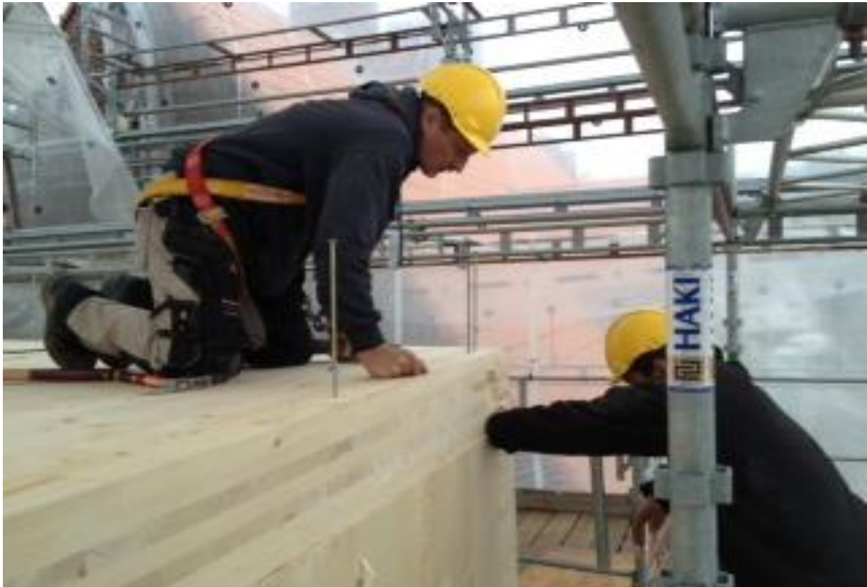
Bilde 8. Massivtre under montering under tak på Grefsen vgs. Undervisningsbygg i Oslo
