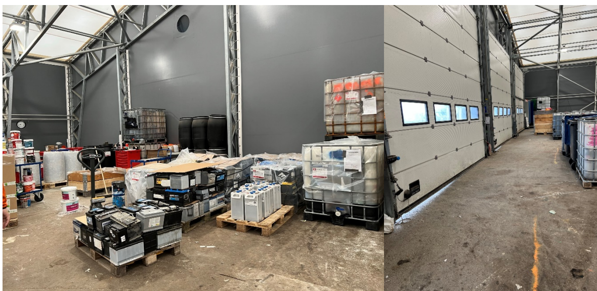
Figur 6: Bildet til venstre viser farlig avfall lagret i lagerhallen for farlig avfall, og bildet til høyre viser sprekker under porten hvor evt. lekkasje fra lagringen kan føre til avrenning.
