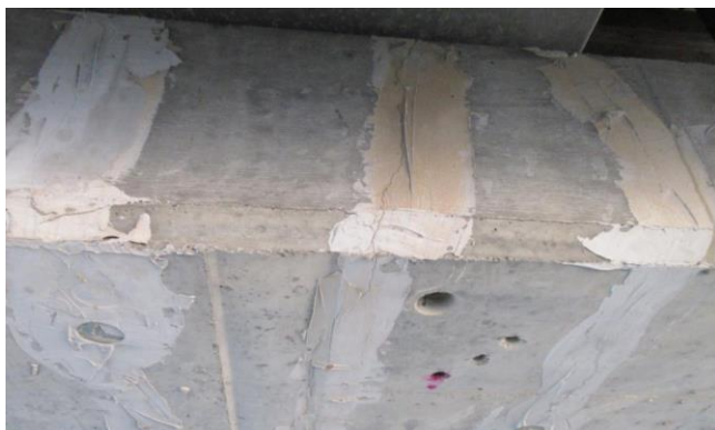
Figur 6-4 Oppripping ved fuge A18/A19. Kilde: Multiconsult for Nye Veier
