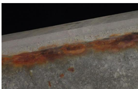
Figur 6-3 Typisk skade ved dryppnese under bruvinge. Kilde: Multiconsult for Nye Veier
