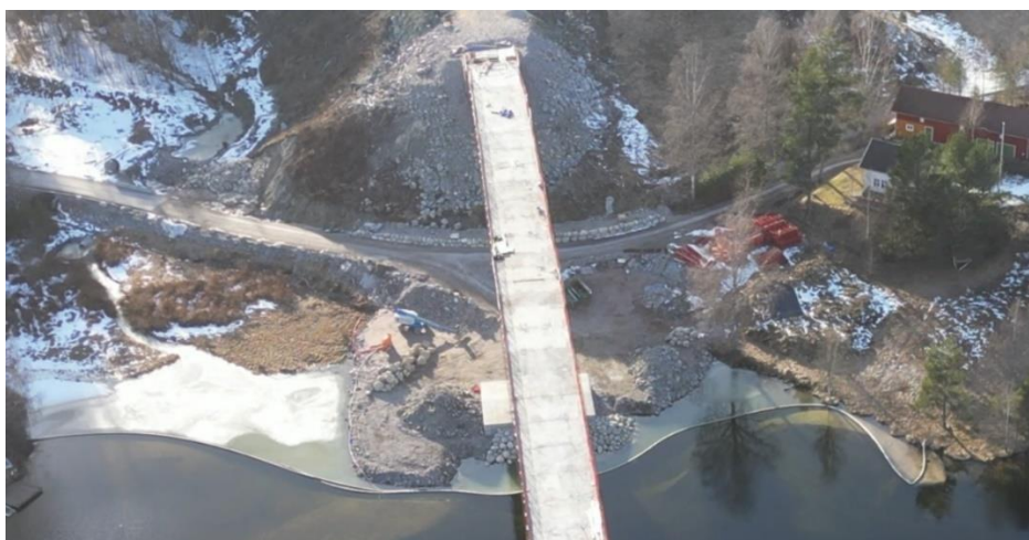
Figur 6-2. Eksempel på utførelse av midlertidig utfylling ved oppføring av bru. Fyllingen i bildet skal fjernes.
