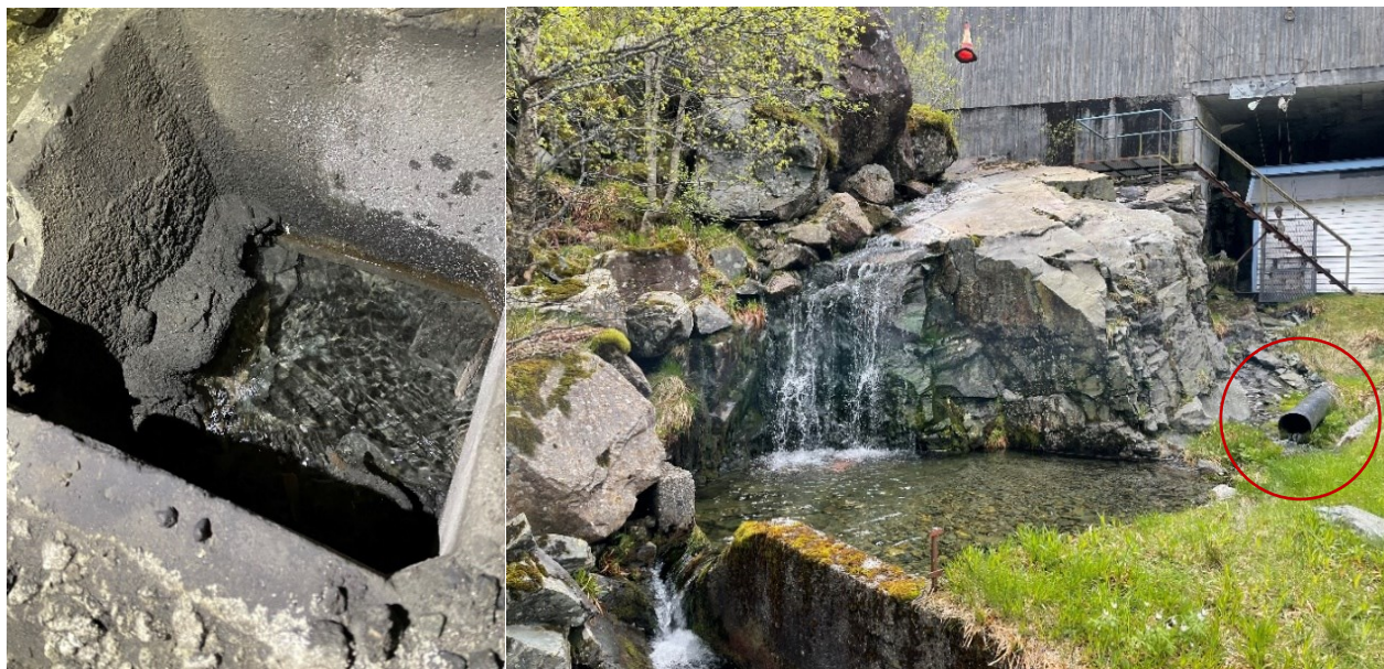
Figur 3-1 Kum i tunnel til eksisterende drenering til venstre, samt utløpet for dreneringen ved portal i nord (vist med rød sirkel), på østre side av veibanen i bildet til høyre.
